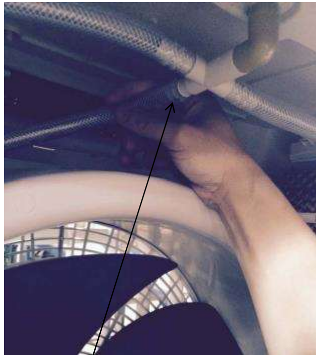
Distribuidor de água
