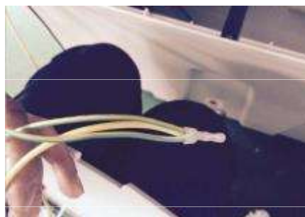
Cabos de aterramento
